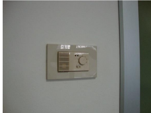
Figura 4.9 – Termostato di regolazione piano secondo ammezzato
