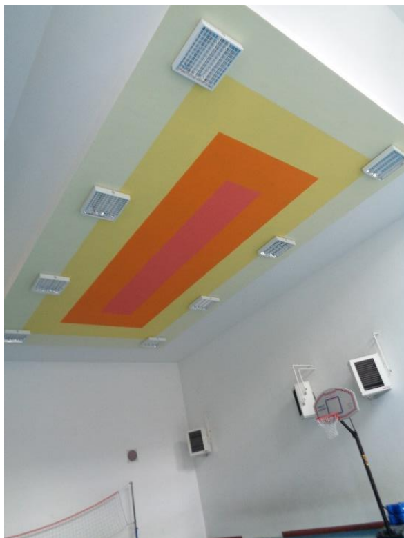
Figura 4.18 - Particolare dei corpi illuminanti ubicati nella Palestra
