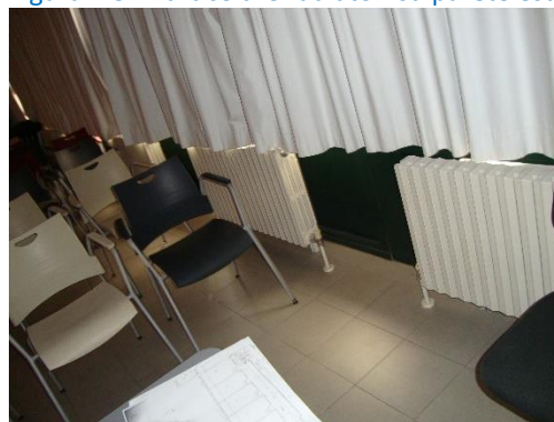
Figura 4.5 - Particolare radiatori su parete esterna
