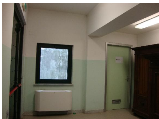
Figura 4.6 – Particolare ventil convettore su parete esterna
